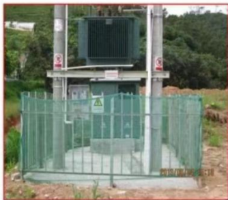
项目部变压器
