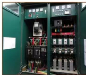
总配电箱(一级)
