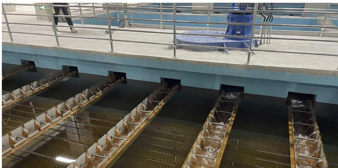
图 22-6 地下水厂内部运行图 2
