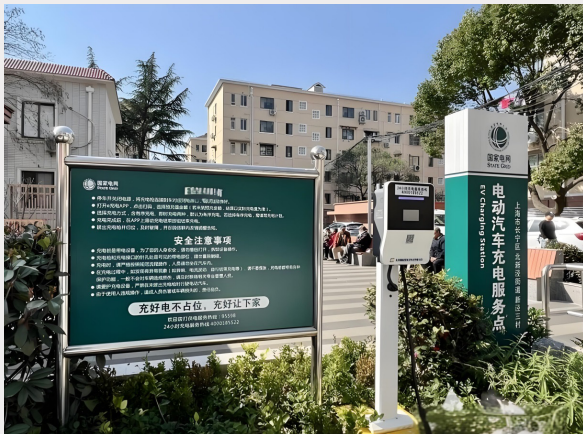
充电桩改造后实景图
