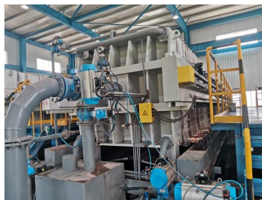
图 2.2-2 尾矿压滤工段
