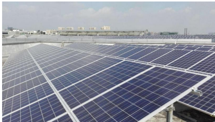
光伏直驱空调电能计量示范工程-光伏阵列
