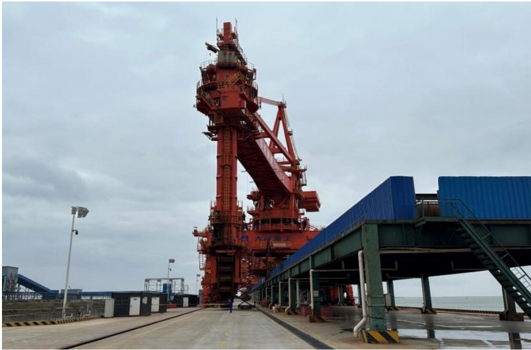
钢结构廊道及链斗式卸船机
